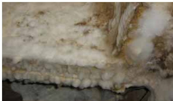
Pleśń na elementach drewnianych
